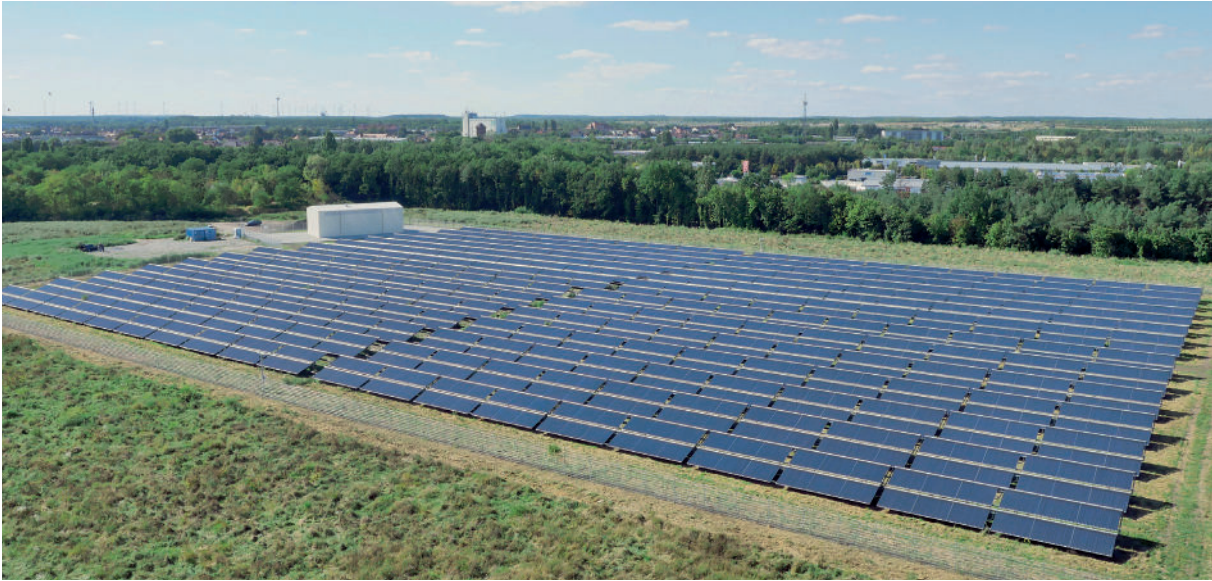
Kollektorfeld von Ritter XL Solar in Senftenberg | Foto: Stadtwerke Senftenberg
