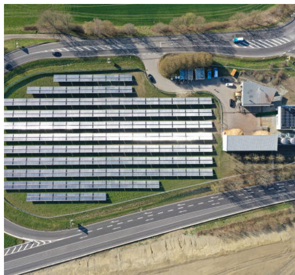
Kollektorfeld in Überlingen am Bodensee von oben | Foto: Stadtwerk am See GmbH & Co. KG
