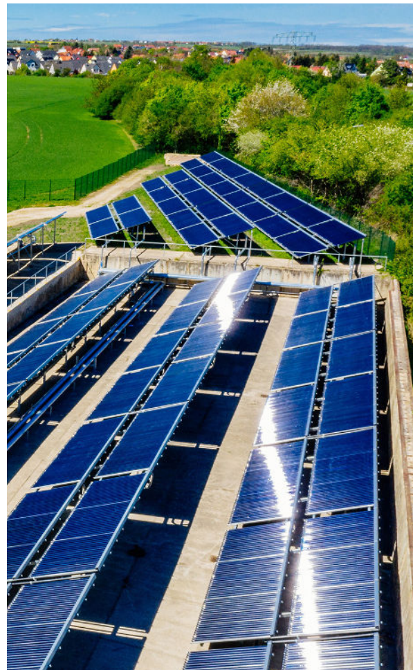
Kollektorfeld in Erfurt | Foto: Steve Bauerschmidt, SWE Energie GmbH
