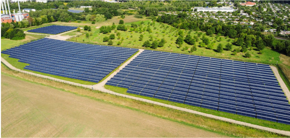
Kollektorfeld in Greifswald | Foto: Stadtwerke Greifswald
